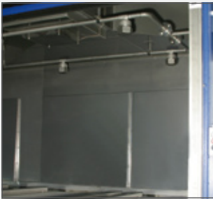
Rohrleitungseinbauten für N 2 -Begasung, Löschanlagen etc. Piping systems for N 2 -pressure, fire fighting etc.
